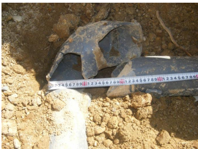
破損した水道管
