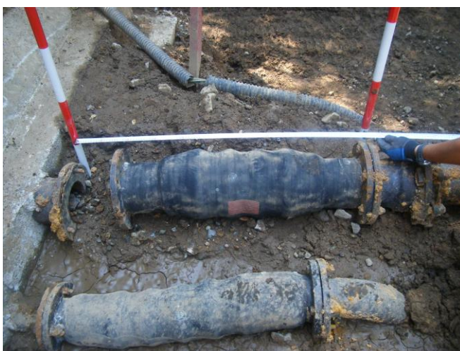
継手部分で接続が外れた水道管
